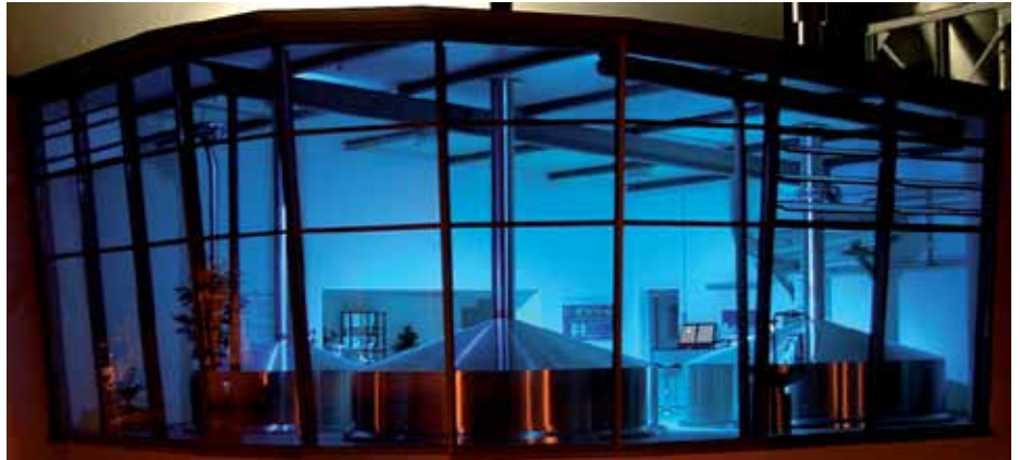
Ein Referenz-Projekt der Firma Nerb ist ein drei-Gefäße Sudhaus mit einer Ausschlagmenge von 120 hl in Nagold
